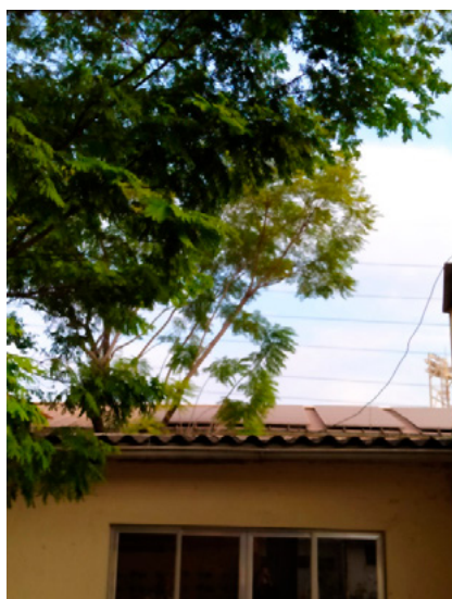
Figura 51 Placas solares instaladas no telhado do Campus Volta Redonda.
