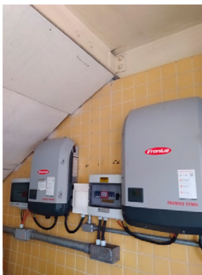
Figura 52 Equipamentos das placas de energia solar.
