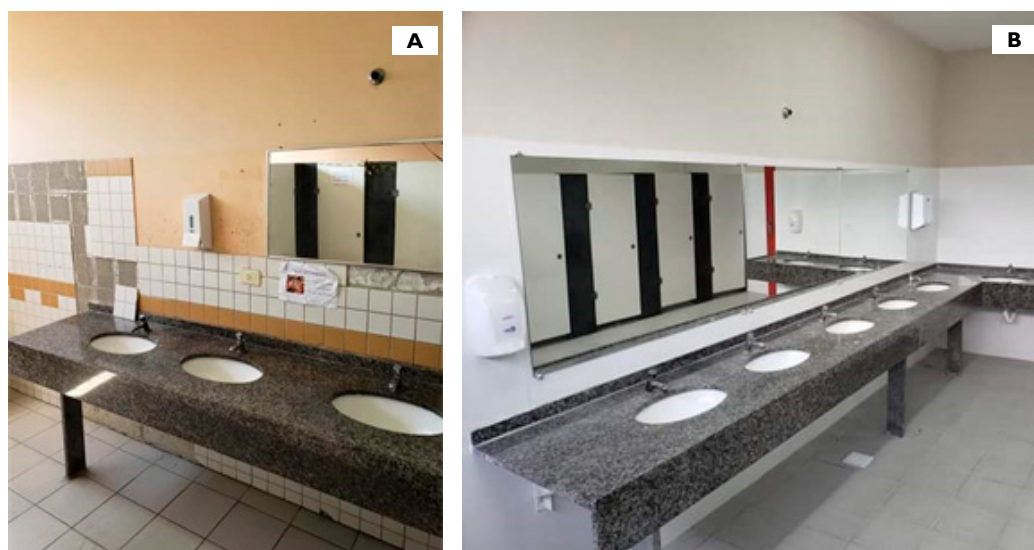
Figura 118 Banheiro do Campus Duque de Caxias. A. Antes da reforma. B. Após a reforma. Fonte: Moacir Romeiro.
